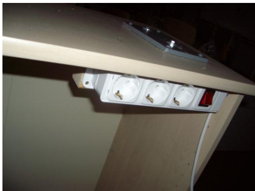
Steckdosenleiste oben angebracht
